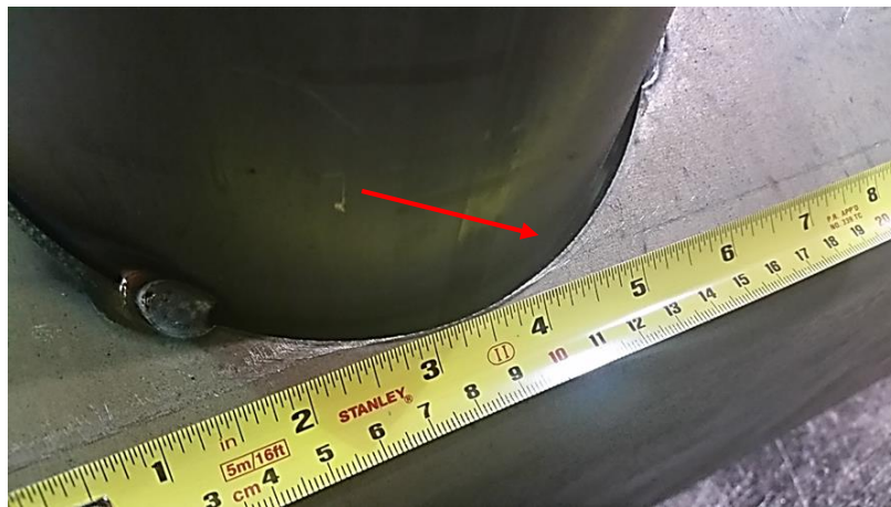
Figura 3.7 Apertura entre las placas del componente 1A-1 y el cuerpo del tanque (30)
