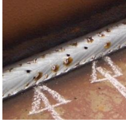
Figura 2.50 Porosidad lineal en soldaduras de filete (28)
