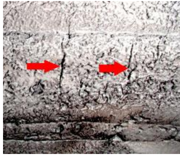
Figura 2.34 Fracturas transversales en el metal de soldadura (28)
