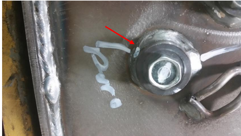
Figura 3.8 Porosidad en el cordón de soldadura (30)
