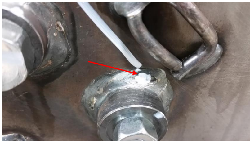
Figura 3.9 Defecto por falta de fusión hacia el final del cordón de soldadura (30)
