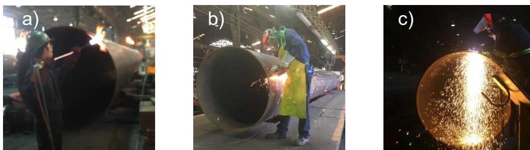
Figura 5.2 Actividades realizadas en planta a) Aplicación de flama, b) corte manual con disco y c) Fundición de metal con plasma.
