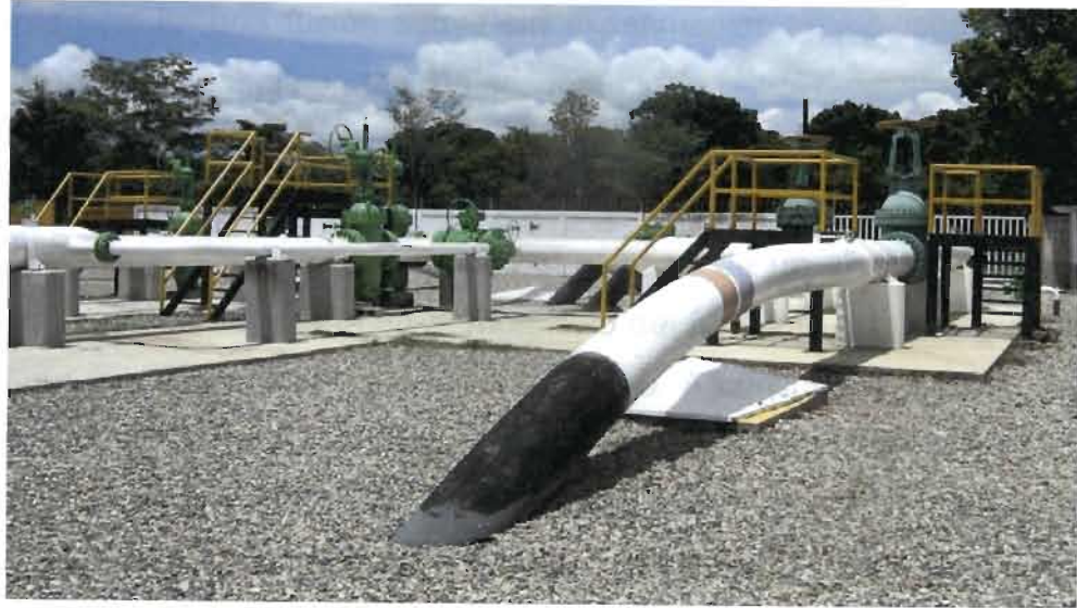
Figura 2.2. Ducto de transportación de hidrocarburo amargo (Cortesía PEMEX Sector Reforma, Residencias Samaria-Costero)
