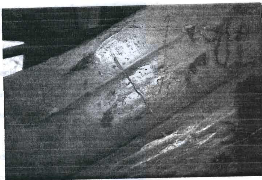
Figura 14 Fotografía mostrando una fractura en la soldadura (7)
