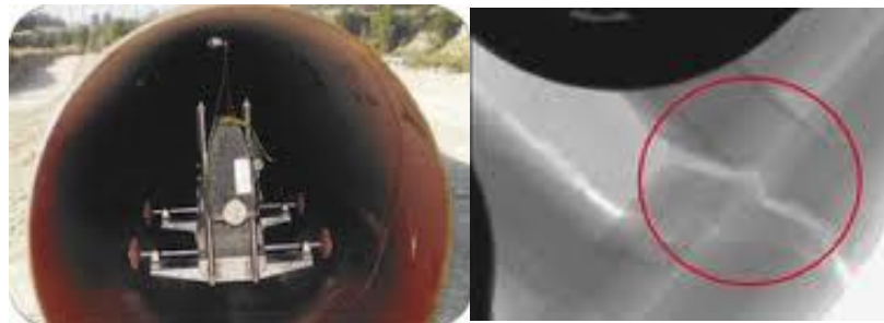
Figura 2.19 Equipo de Rayos X a) y b) Radiografía de una grieta transversal. [11].
